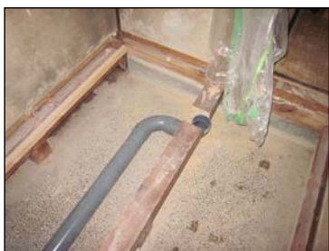
大引き切断のまま放置
